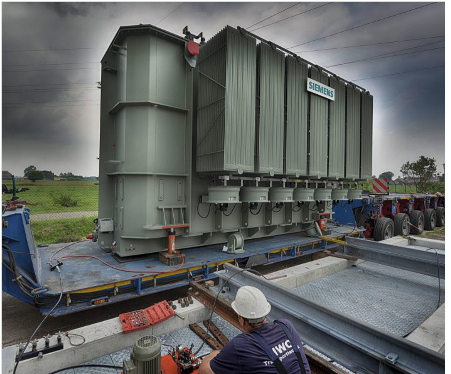
Gestern ist der neue Transformator im Umspannwerk der EWE in Marienhafe am Elfenveerweg aufgestellt worden.
